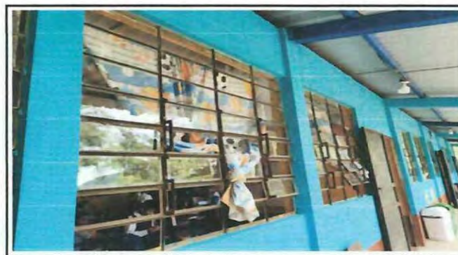
Foto 4: VENTANAS SELLADAS Y EN MAL ESTADO, SUSTITUCIÓN DE VENTANAS POR LAS INCLEMENCIAS DEL TIEMPO (CALOR)
