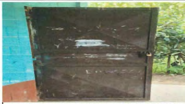
Foto 2: PUERTAS SIN CIERRE SEGURO, SUSTITUCIÓN DE CHAPA EN PUERTAS
