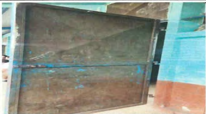
Foto 1: PUERTAS EN MAL ESTADO, MANTENIMIENTO DE PUERTAS
